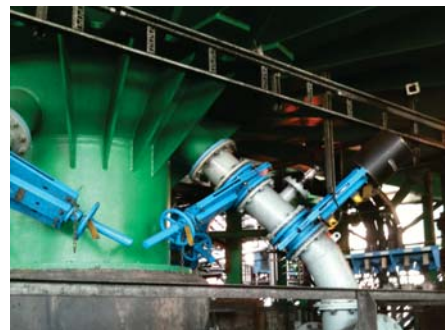
Planta de Lavado de Carbon
